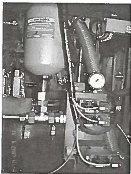
VÁLVULA DE PROTEÇÃO HIDRÁULICA
